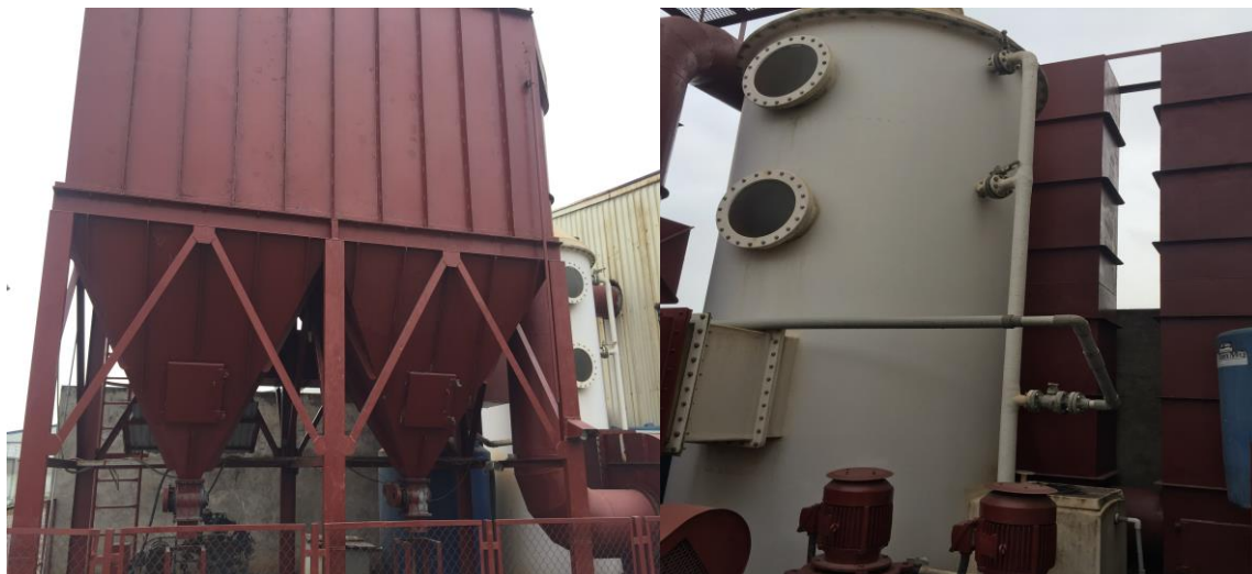
Hình 7: Thiết bị lọc bụi túi vải và tháp hấp thụ
